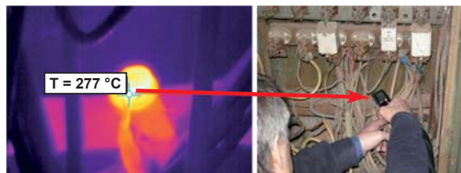
Применение тепловизора для проверки пожарной опасности электрических щитков.
