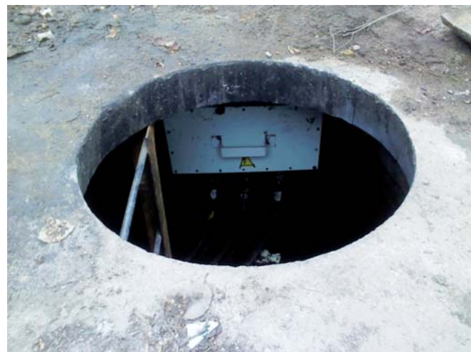
Рис. 2. Размещение коробок в верхней части подземного железобетонного колодца
